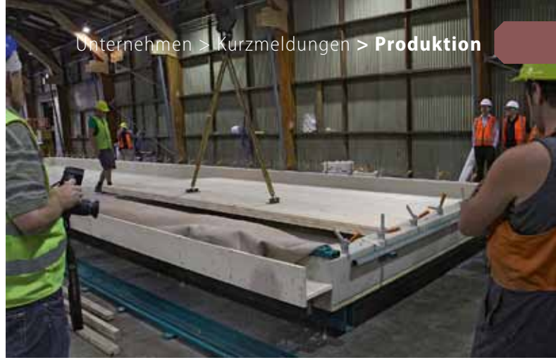
Erste neuseeländische BSP-Platte wird aus der neuen Woodtec Fankhauser-Vakuumpresse bei XLam NZ gehoben
