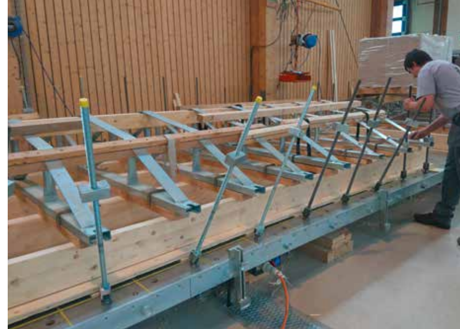
Um die Deckenelemente möglichst schlank zu halten, wurden sie als Rippendecken verklebt und mit der pneumatischen Pressvorrichtung der Woodtec Fankhauser GmbH mit bis zu vier Tonnen pro Presseinheit verpresst.
