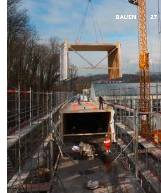
Die Elemente für das 40 Meter lange Gebäude wurden als vorgefertigte Module auf die Baustelle geliefert.
